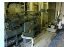
経年 35 年の空調機部品 供給に支障があり故障 も多い
