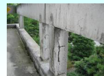
ベランダコンクリート 手摺りの劣化状況
