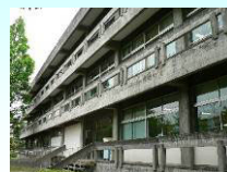
図書館玄関付近 外壁コンクリートは 黒ずんでいる
